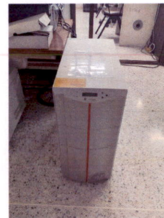
ชื่อ : เครื่องสำรองไฟฟ้าฉุกเฉิน (ยี่ห้อ GE Digital รุ่น LP10-11)
